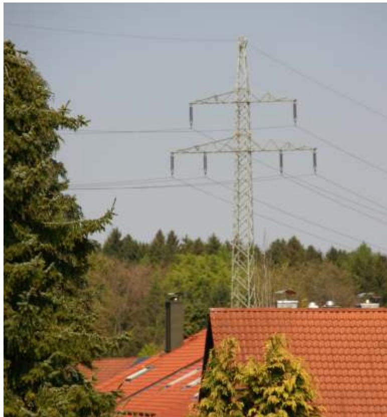
Die Hochspannungsleitung über Neuried gehört zum Überlandnetz und damit nicht zum Regionalwerk - der Umgang damit zeigt aber, welches Gewicht lokale Interessen für E.ON haben.
